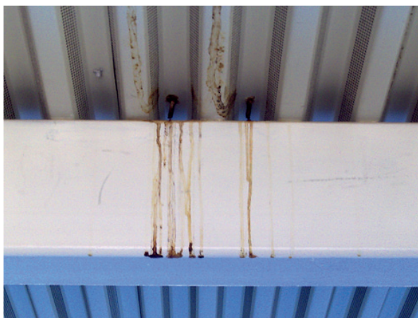
Koroze u samovrtných šroubů
